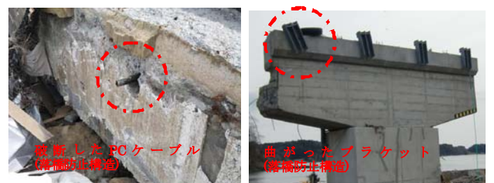
図16 落橋防止構造の損傷
