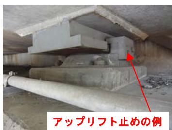
写真 14 アップリフト止めの有る支承
