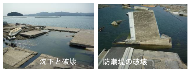
写真4 岸壁部と防潮堤の破壊状況
