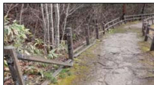
写真2 柵のビーム部の脱落
