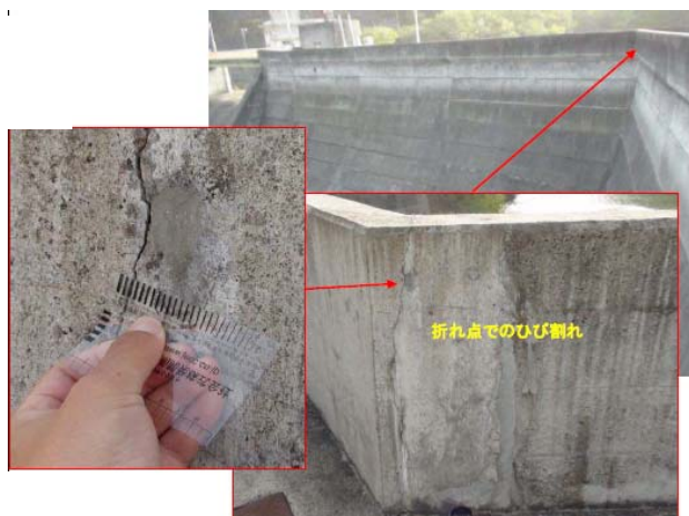
図2 岳ダムでの構造変化点での損傷
