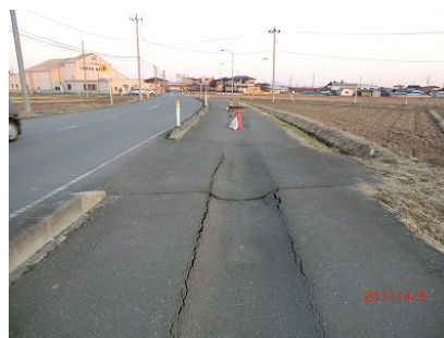
写真6 液状化による路面沈下 (宮城県栗原市内)
