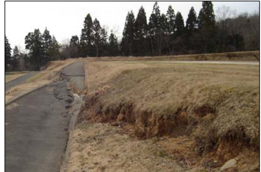
写真9 小千谷市白山運動公園の切盛境の側方流動 (中越地震)
