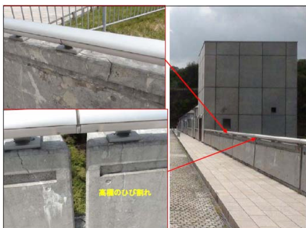
図3 三春ダムにおける高欄部ひび割れ
