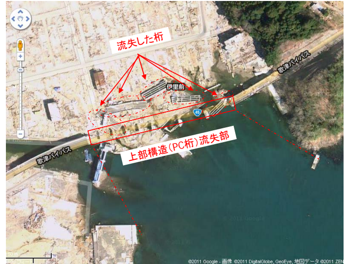
図13 歌津大橋_津波による桁流失
