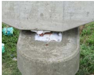
写真6 固定支承脱落
