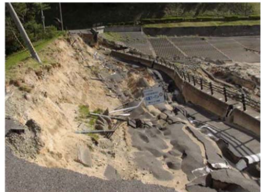
写真 6 福島県 藤沼貯水池の被災状況
