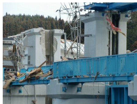
写真3 門柱付近の損傷状況
