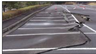
写真4 駐車場の側方流動
