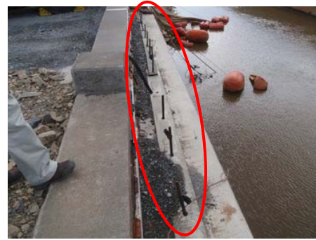
写真-16 上立切橋の被災状況(その2)
