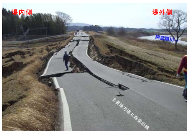
写真7 震災直後の被災状況 6)
