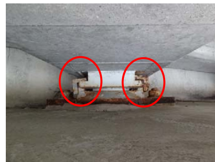
写真-6 浜畑橋の支承の浮き上がり(その1)
