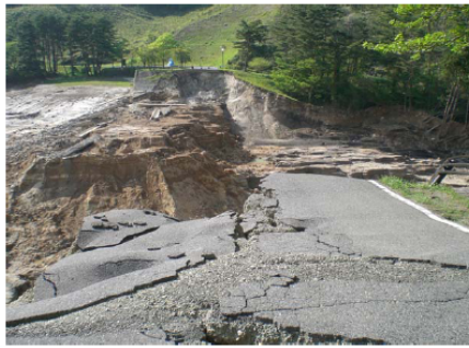
② ダム軸右岸側から左岸望む 左岸側の堤防は残存し、堤体の下流側は筋状に流水で浸食され、流出する。
