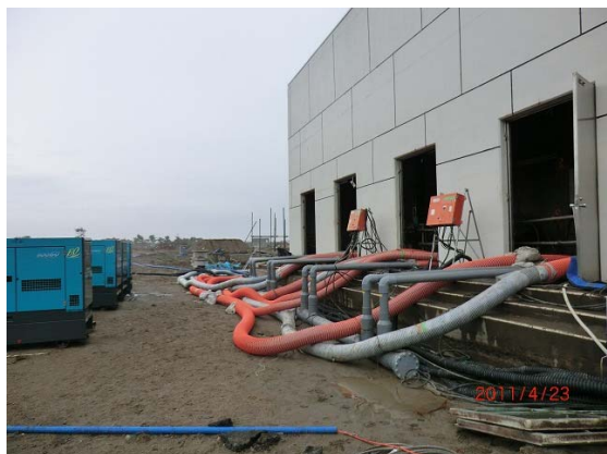
図 8 流入ポンプ棟からの仮配管（宮城県内）
