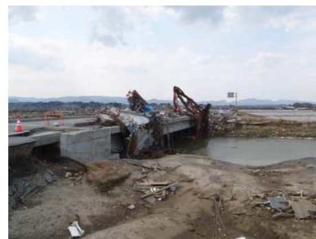
写真-12 新館野橋の被災状況(その1)
