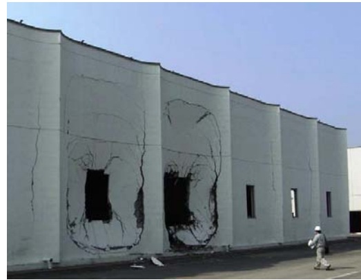
写真 5 南蒲生ポンプ場の津波による被災状況
