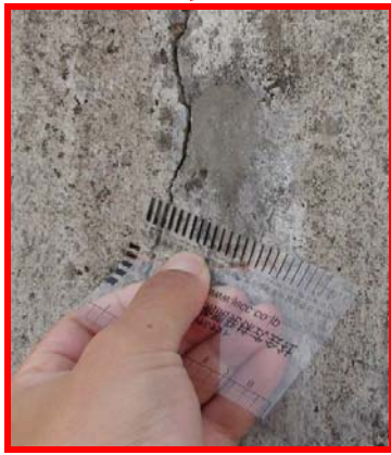
写真 15 堤体のひび割れ
