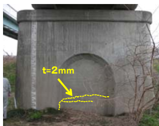
写真8 隔壁ひびわれ
