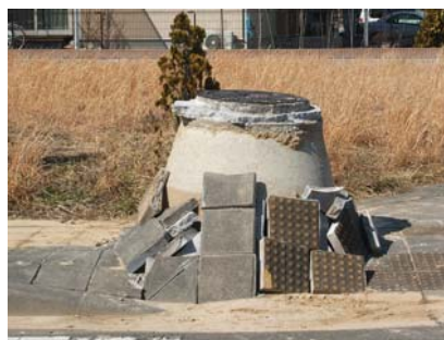
写真5 液状化による人孔の隆起 (宮城県白石市内)
