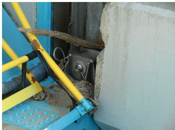
写真8 ローラーの衝突痕
