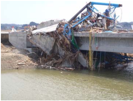
写真-13 新館野橋の被災状況(その2)
