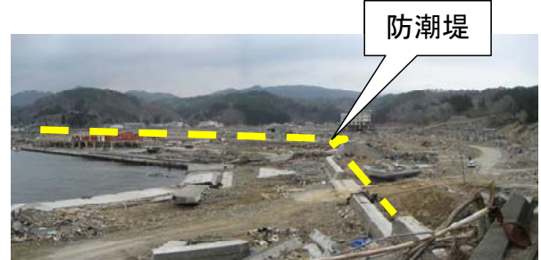
写真1 破堤箇所全景
