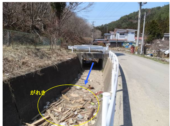
写真15 長内川右支川 河口から1.0km地点の流路工の状況 (流路工には被害なし)
