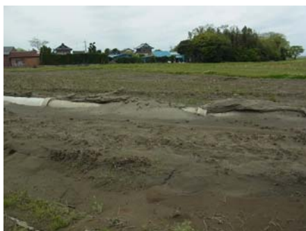
写真4 液状化による管路の浮上 (茨城県内)
