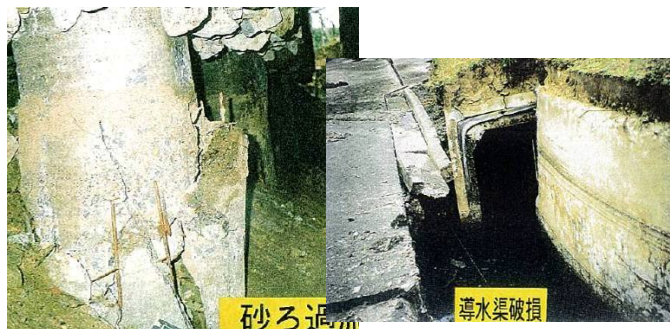
写真 2 1995 年兵庫県南部地震による東灘処理場の被害状況
