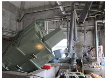
写真9 蛸の浦浄化センター内部被災状況
