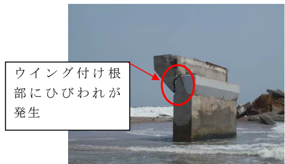
写真-2 小塚橋被災状況(その2)
