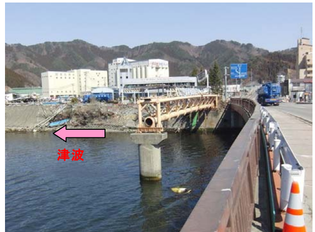
写真6 矢の浦橋上流側の水管橋の流失
