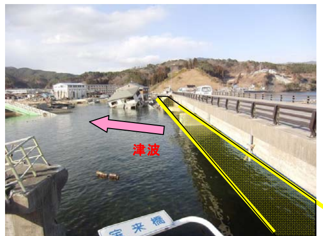
写真3 宝来橋側道橋の流失状況
