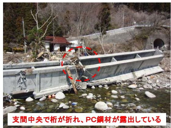
写真9 荒川橋上流の南リアス線の落橋
