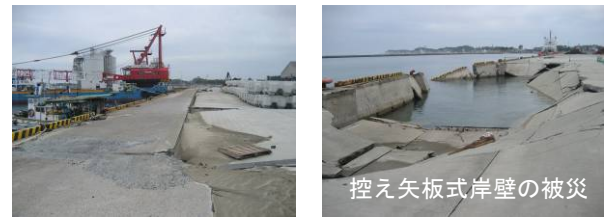
写真7 液状化による被害状況（相馬港）
