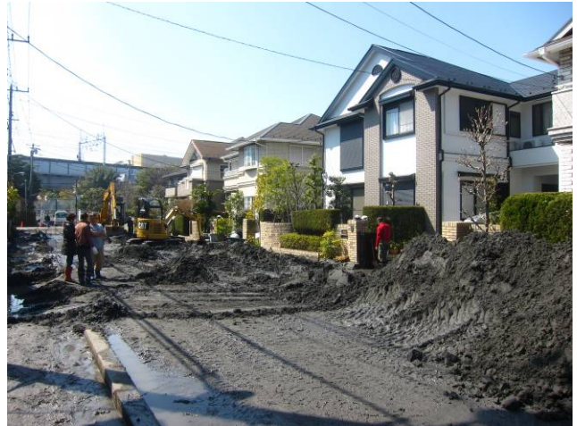
写真7 浦安市での噴砂の発生状況 (片付作業中)
