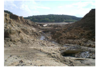
④ 右岸側破堤断面
