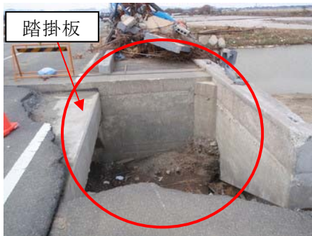
写真-14 新館野橋の被災状況(その3)
