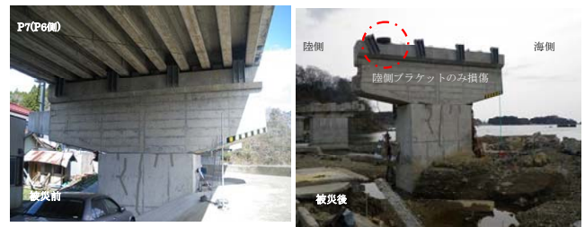
(被災前) (被災後) 図 20 P7 橋脚の変位制限構造
