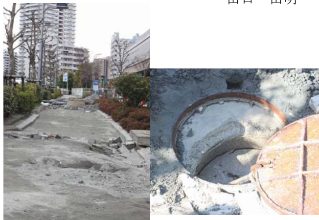
写真1 管路被害の事例（浦安市）
