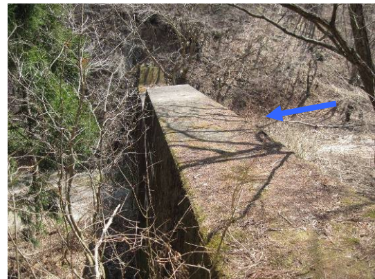
写真14 長内川右支川 河口から1.5km地点の砂防えん堤工の状況 (異常なし)
