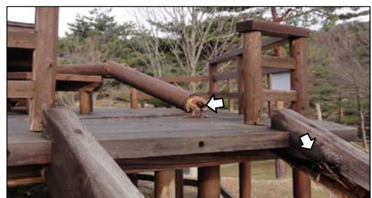
写真10 倒壊した四阿の腐食 (花巻広域公園)
