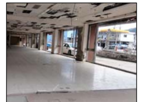
写真32 津波避難ビル1Fの被災状況
