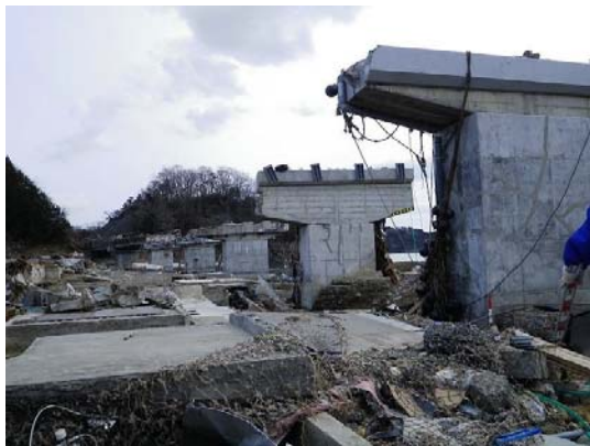
写真 4 道路橋の津波による桁の落下の状況 (国道 45号 南三陸地区 歌津大橋)
