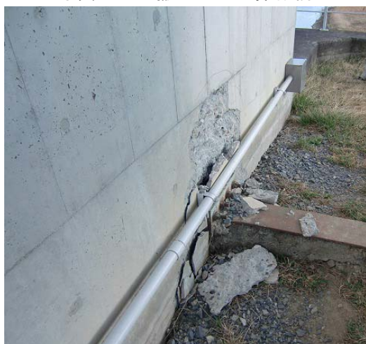
写真12 門柱基部のひび割れ
