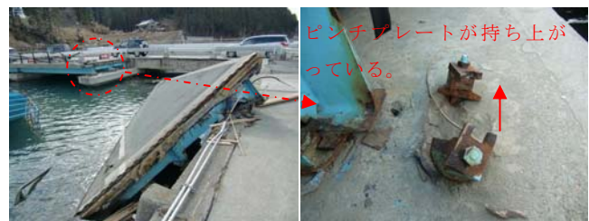
図 22 類似被災事例 (水尻橋)
