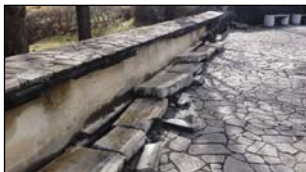
写真5 小端積の倒壊
