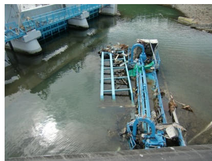
写真4 水門と操作橋の流出
