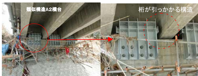
図 18 P9 橋脚上の桁流失メカニズム
