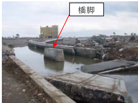
写真-3 釣師橋被災状況
