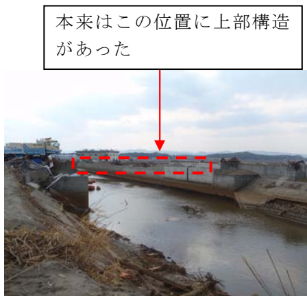
写真-15 上立切橋の被災状況(その1)
