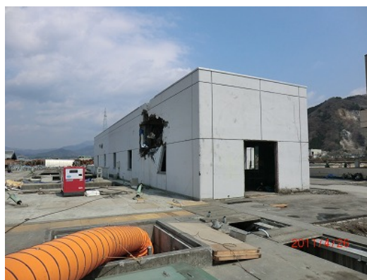
図7 津波被害を受けた処理場の事例(大船渡市)
