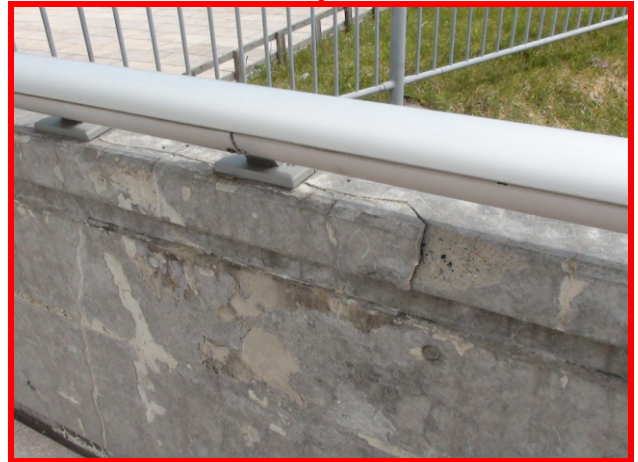
写真 17 堤体天端の高欄のひび割れ
