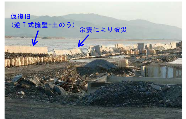
写真 4 仮復旧された堤防の被害
