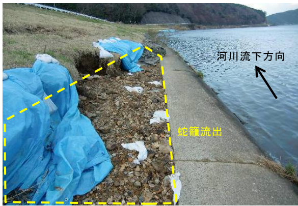
写真5 堤防法尻部(堤外側)の被災状況
