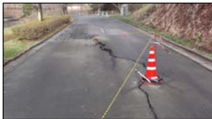
写真3 園路のクラック
