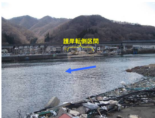
写真1 甲子川 護岸転倒状況
